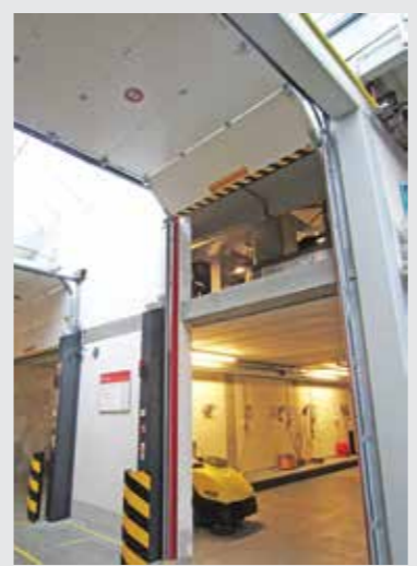
De nieuwe brandpoort aan het batterijlokaal
