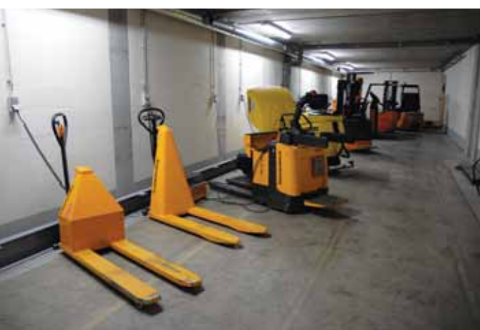
▲ Ruimte met batterijladers
