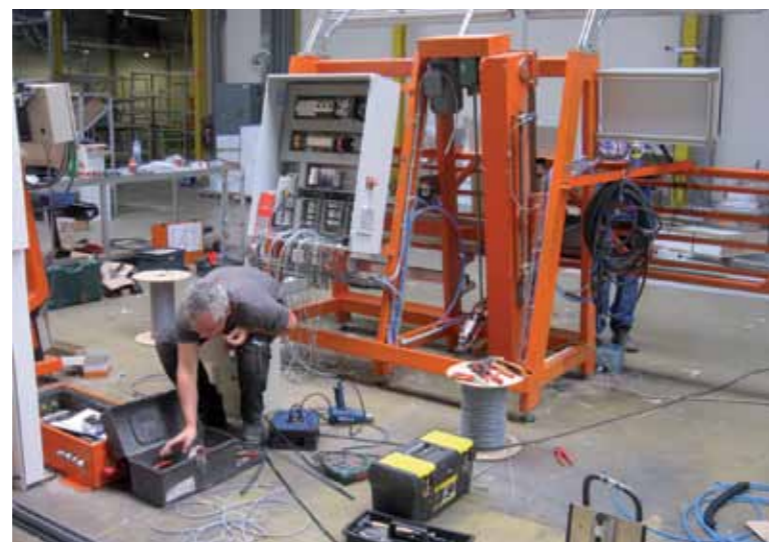
⬆ De houtzaag van lijn 2 werd volledig gereviseerd en opnieuw geschilderd. Consultant Koen Vermant installeert hier de nieuwe stuurkast
